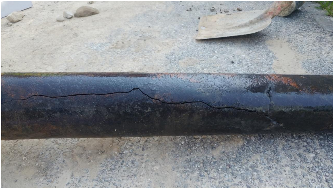
Riss in der Graugussleitung
