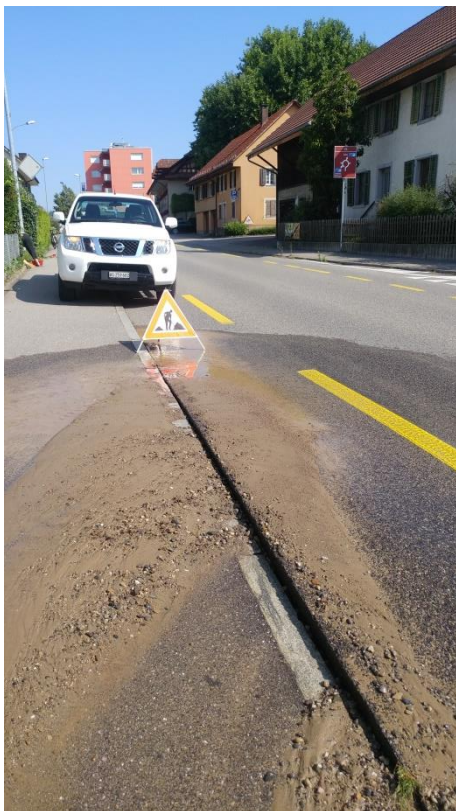
Der Deckbelag der Niederrohrdorferstrasse wurde durch das austretende Wasser stark angehoben
