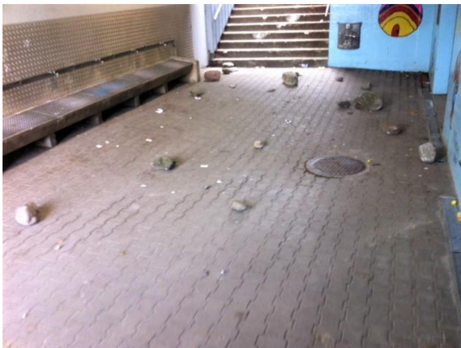
Massive Beschädigungen an einer Aussentreppe der Schulanlage Leematten
