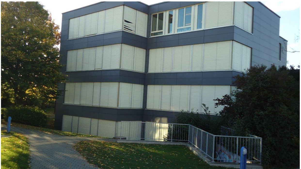
Defekte Storen im Schulhaus Leematten II
