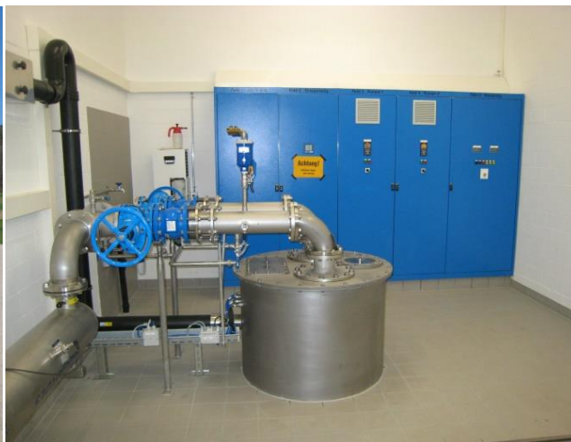
Betriebsraum im GWP Moos
