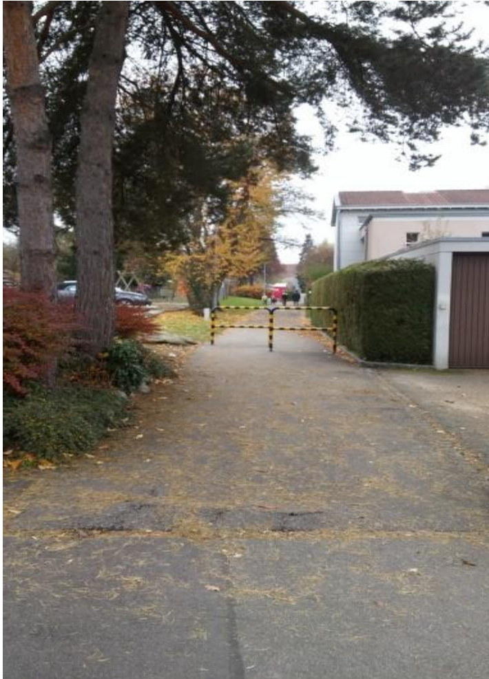
Belagsschäden beim Fussweg Schulanlage Leematten und Spielplatz Tannenburg
