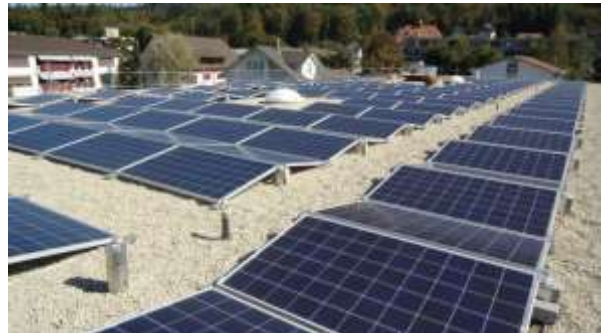
Fertig montierte Photovoltaikanlage auf dem Neubau "Kolibri"
