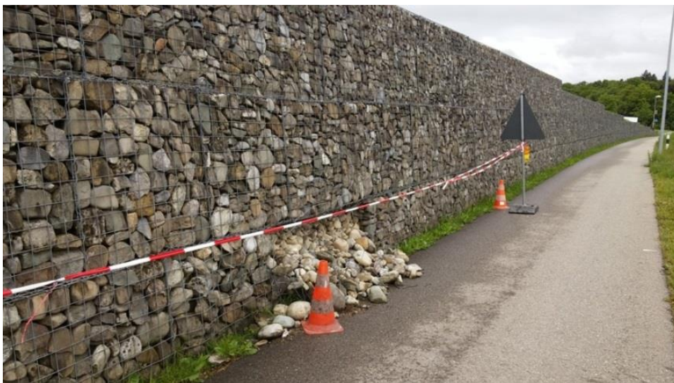
Beschädigte Steinkorbmauer entlang des Radweges in Fahrrichtung Mellingen
