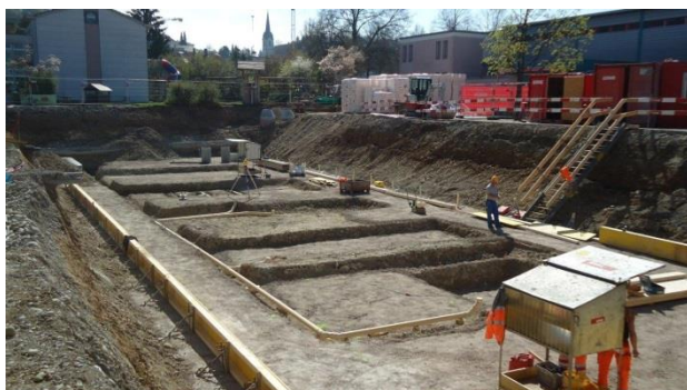
Aushub mit Vertiefungen für den Lift und die Wandfundamente sowie verlegte Kanalisationsleitungen
